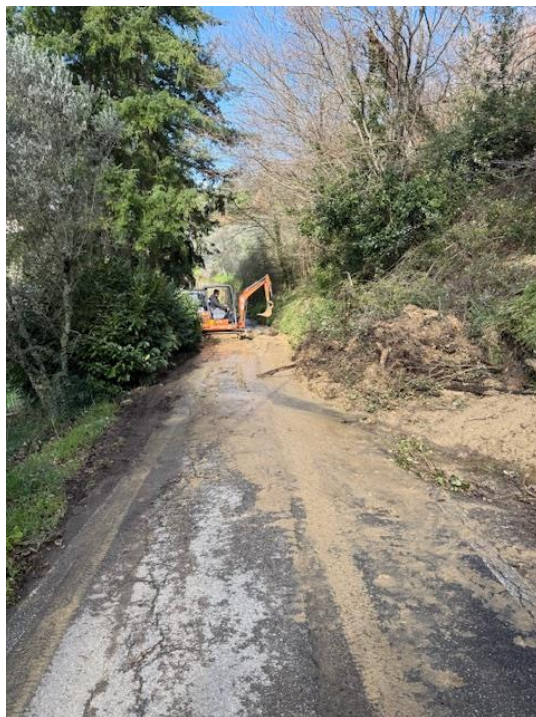
Immagine del cedimento della scarpata di monte
