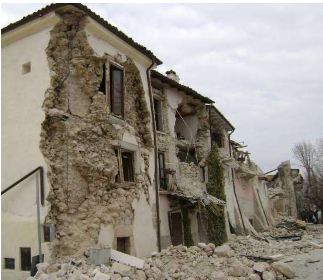
Sisma Abruzzo 2009 Murature molto scadenti crollate
