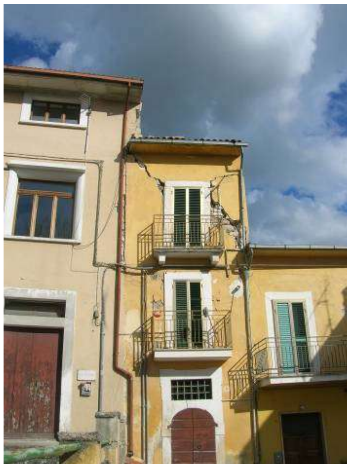
Sisma Abruzzo 2009 Martellamento tra edifici
